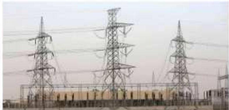
محطة سدير لتحويل الكهرباء
